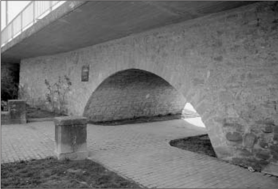
Foto 14 Vista de uno de los estribos en piedra sobre el que descansa el tablero de hormigón del puente actual. Este estribo se construyó a mediados del siglo XIX para aguantar el peso y empujes del puente colgante, popularmente conocido como “el puente de alambre”; posteriormente se adaptó para soportar la estructura del puente de hierro
