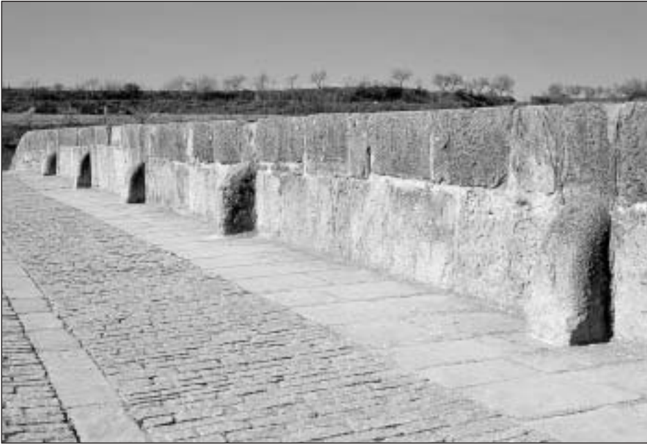
Foto 12. Vista parcial de la calzada del puente. El pretil con guardarruedas corresponde al ensanche de la calzada en el siglo XIX; el pavimento con adoquines es de la restauración acometida en 1989
