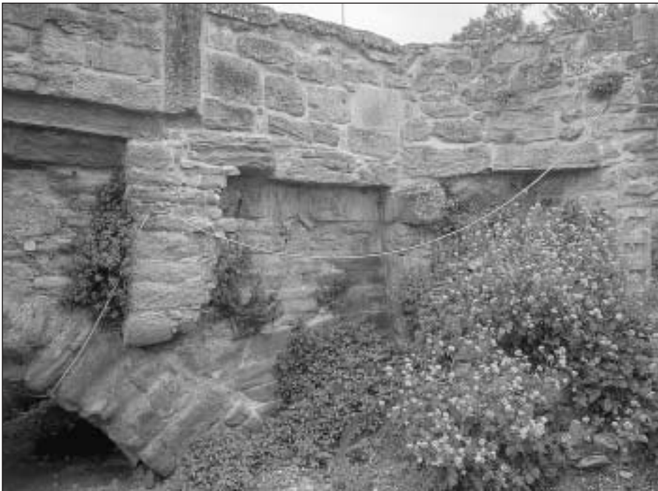
Foto 5. Detalle del primer arco occidental sobre su manguardía, transformada en el siglo xix. Obsérvese en la fábrica del puente los restos de cimentación del torreón/portal que sobre él se levantaba desde la Edad Media hasta los siglos modernos
